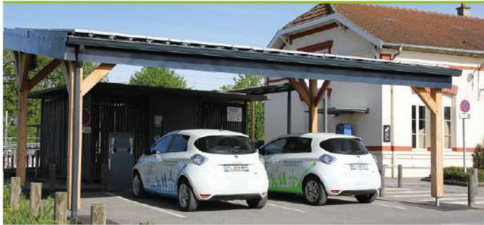
Ombrière photovoltaïque de Poix-Terron.
